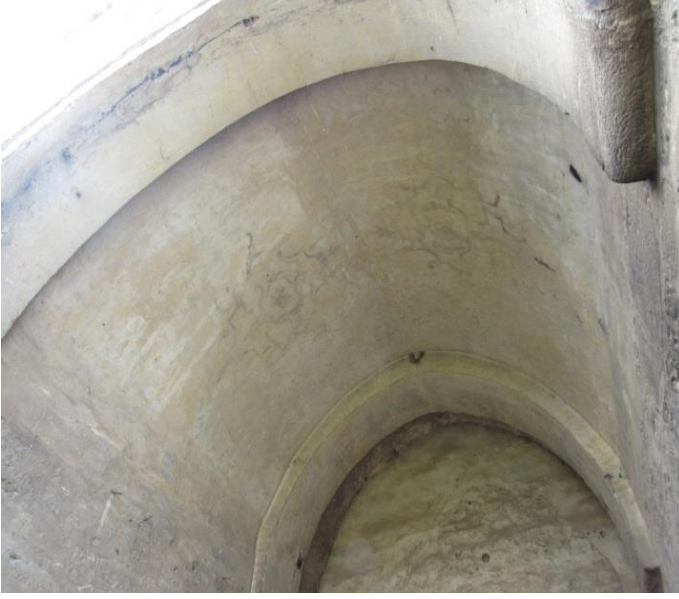
Sıva ve kalem işi kalıntıları
